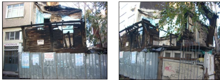
Şekil 4.138: Nakşi Sokak'ta bulunan, 42S kodlu yapının yıkıldıktan sonraki görünümü (Gökçe Ürk, 2009)
