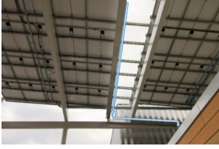
Şekil 5. 52. Kendeda Binası Çatıdan Gelen Yağmur Suyunun Yönlendirilmesi.
