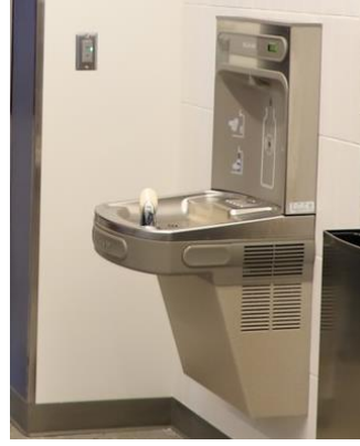
Şekil 5. 54. Tesiste Bulunan enerji ve su verimli İçme Suyu İstasyonu
