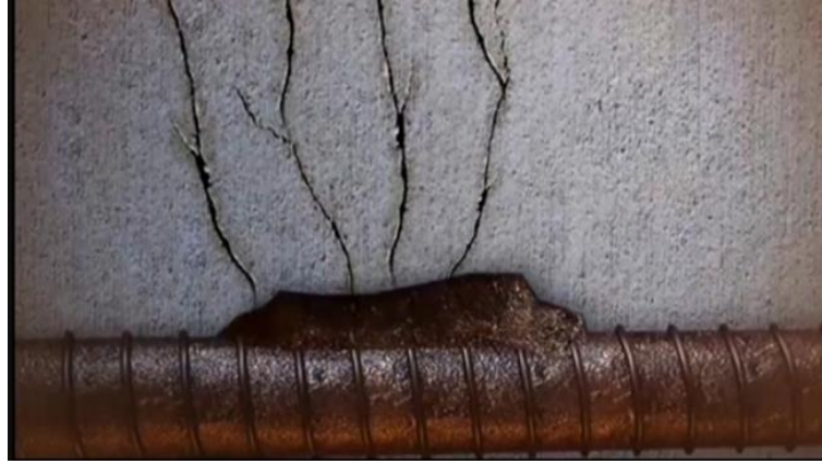
Şekil 2.8. Yapıdaki korozyon sonucu ortaya çıkan ve betona zarar veren ürün (URL-1)
