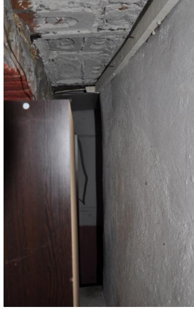
Şekil 4-179 B/1-02 Ofis, yangın duvarı (Şık, Tekirdağ, 2012)
