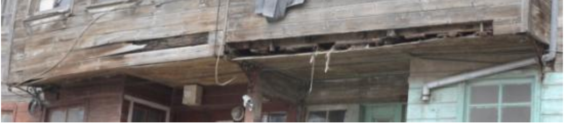
Şekil 4-131 15 ve 17 No'lu Yapı Kuzey Cephesindeki Demir Payandalar (Şık, Tekirdağ, 2012)
