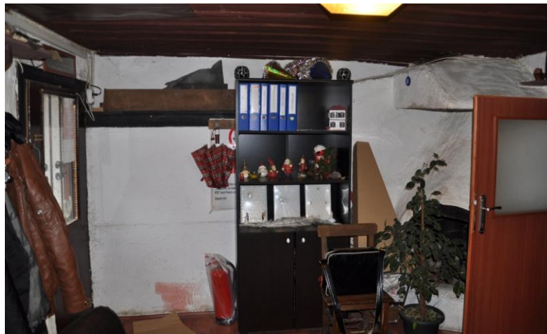
Şekil 4-178 B/1-01 Ofis, yangın duvarı (Şık, Tekirdağ, 2012)
