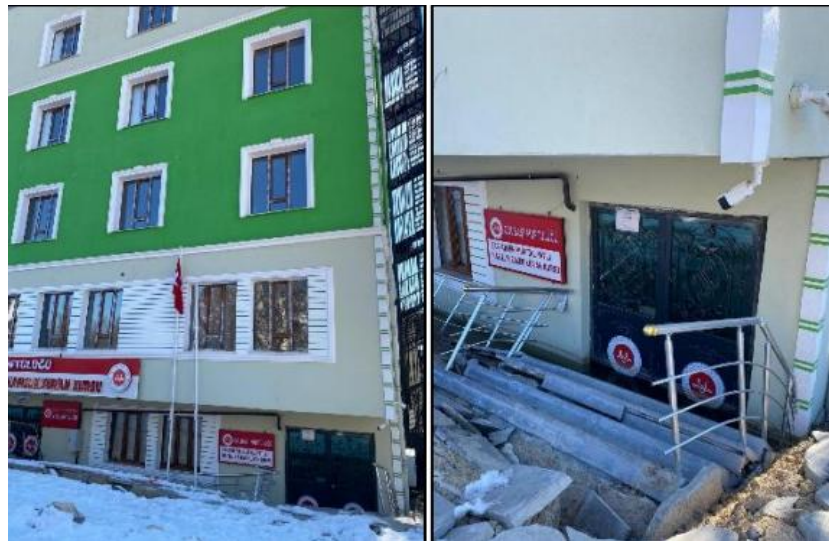
Şekil 2.1 Sıvılaşma kaynaklı oturma gözlemlenmiş bir yapı (Gölbaşı, Adıyaman, 2023 Kahramanmaraş Depremleri)
