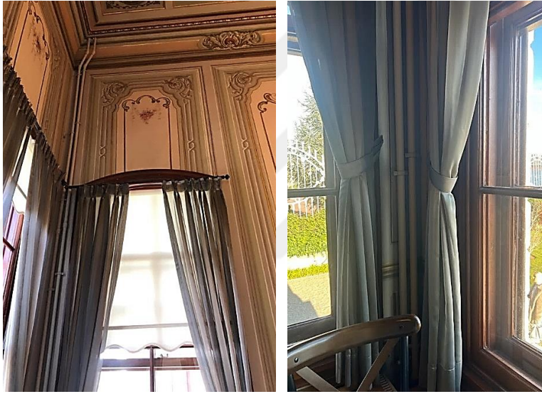
Görsel 5. 6. Çay Salonu ısıtma sistemi, kalorifer boruları (Mavi, 2024)
