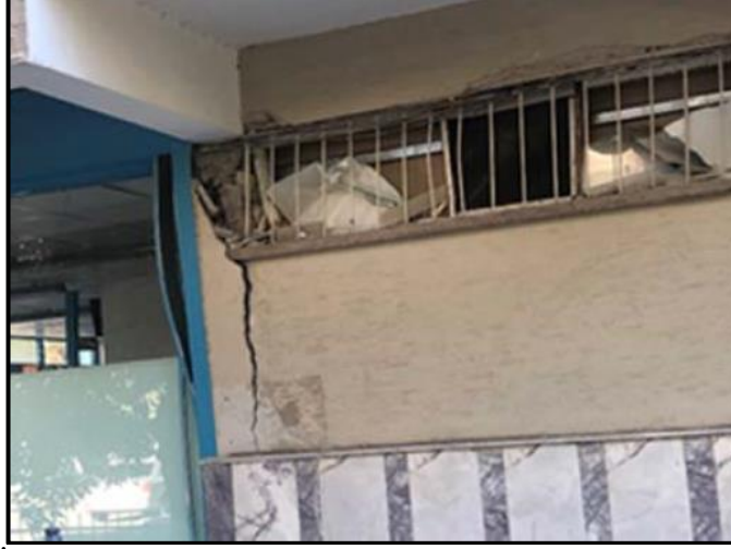
Şekil 3.7. 2020 İzmir Depreminde bir binada bant pencerelerde meydana gelen hasar (IMO, 2020)
