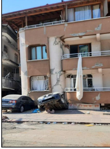
Şekil 3.14. 6 Şubat depreminde Hatay’da yumuşak kat sorunu sebebiyle yıkılan bir yapı (MO, 2023).
