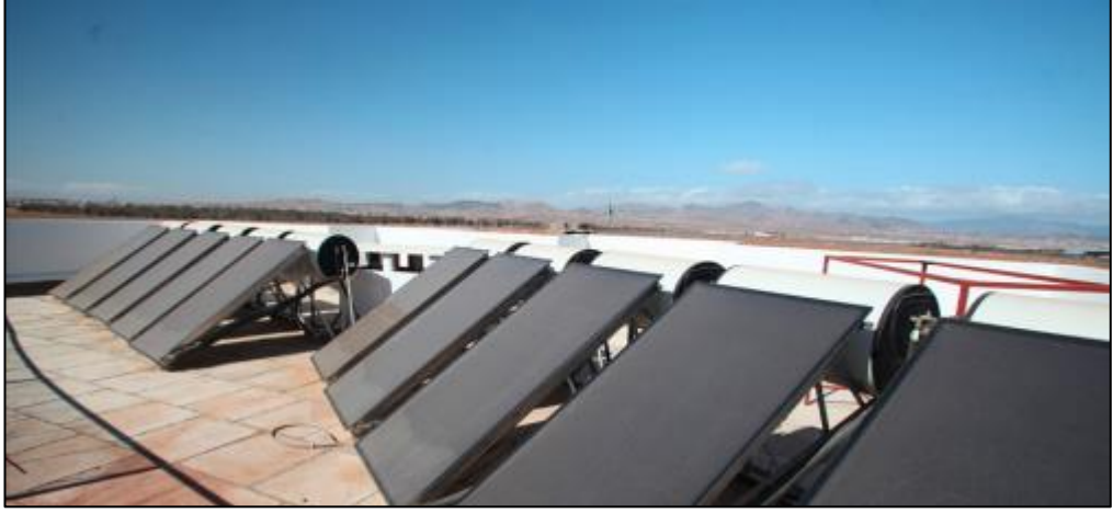
Şekil 4.8. Al Ouroud projesinde çatı katındaki güneş kolektörleri ( https://alomrane.gov.ma , 2018)
