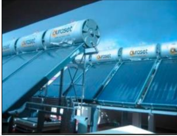
Şekil 4.17. Al Karama projesinde çatılarda kullanılan güneş kollektörleri ( https://alomrane.gov.ma Al Omrane, 2017)
