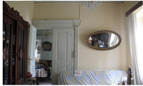
Z-09 doğu duvarı
