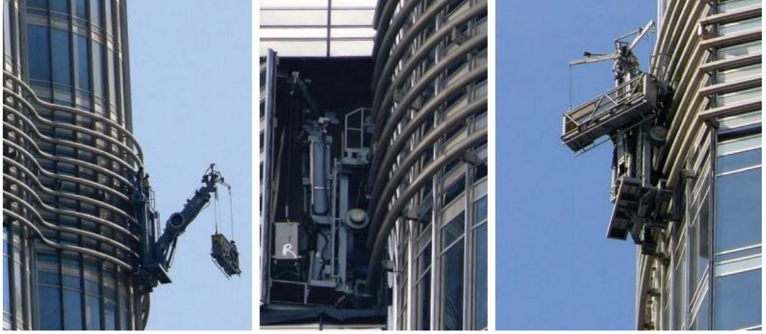
Şekil 5.29. Burj Khalifa cephe bakım sistemi
