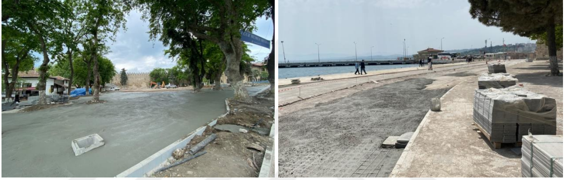
Şekil 5.7: Proje kapsamında alanın büyük bir kısmı beton zemin ile kaplanmıştır (Yazarın özel arşivi).
