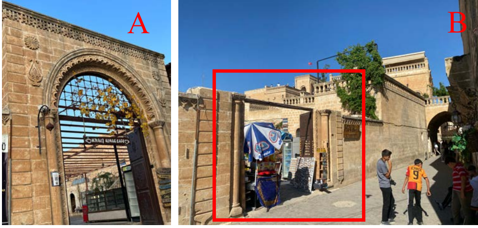
Şekil 33. Restorasyon ile birlikte yıkılan ana giriş kapısı(A), Mevcut durumu (B) (H. TUNÇ, 2025, Kişisel Arşiv).
