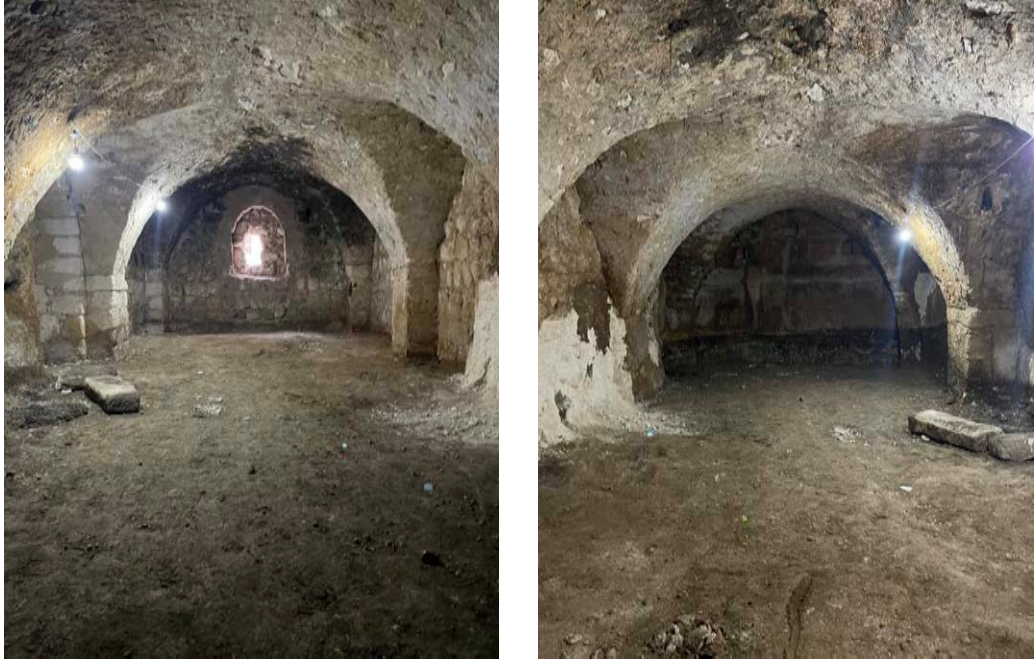
Şekil 116. Bodrum kat onarım öncesi
