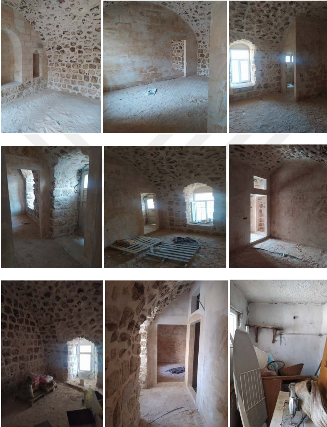
Şekil 210. Zemin kat odaların restorasyon öncesi.
