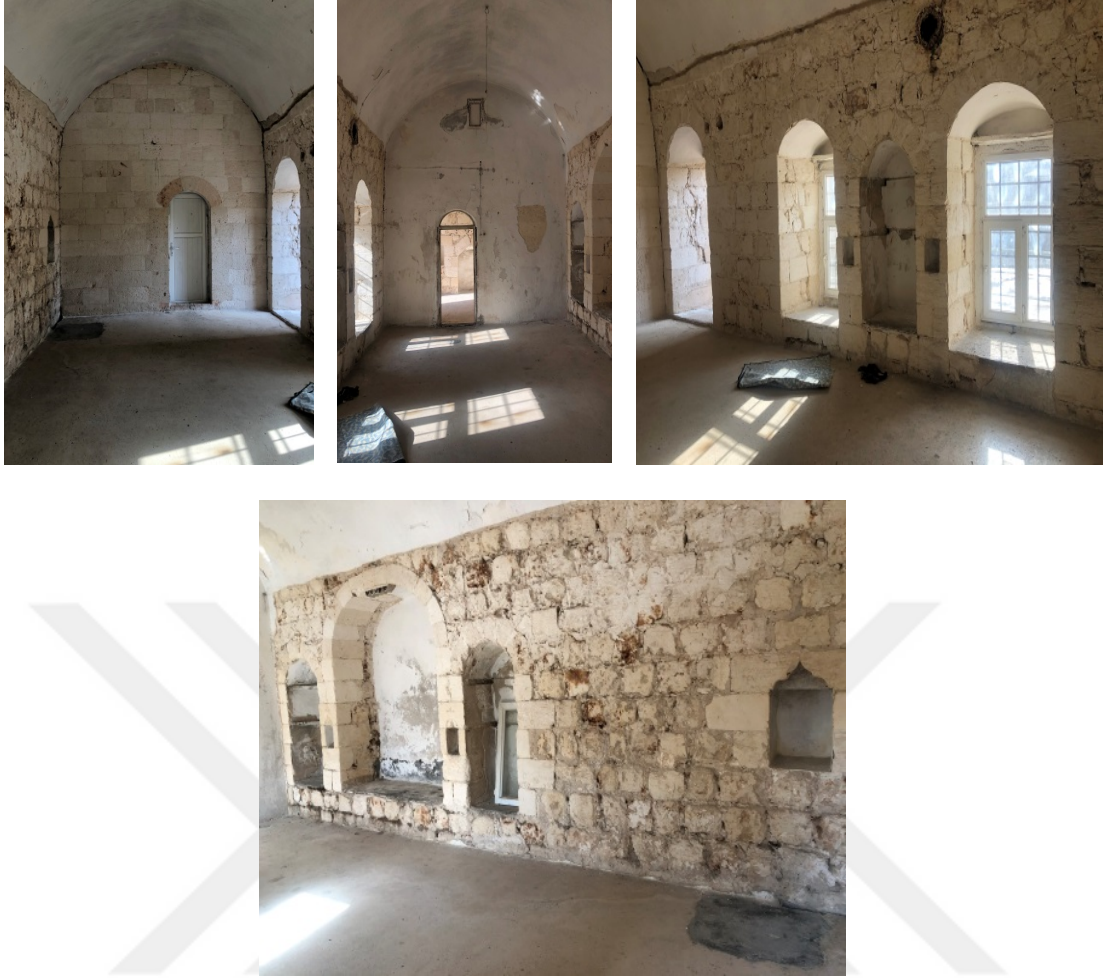
Şekil 68. Zemin kat onarım öncesi (R. DAŞ; Arşiv,2025).
