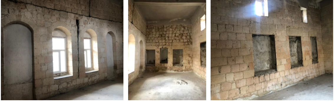
Şekil 76. Zemin kat onarım öncesi
