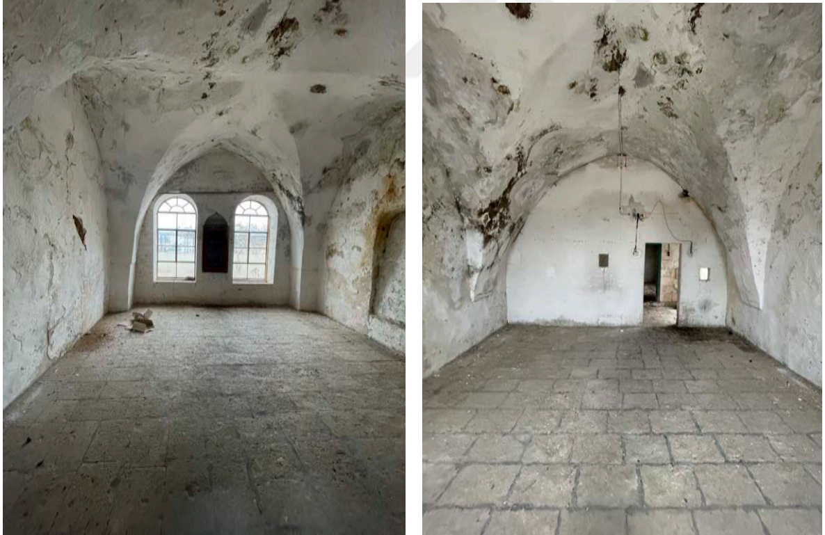
Şekil 128. Zemin kat onarım öncesi
