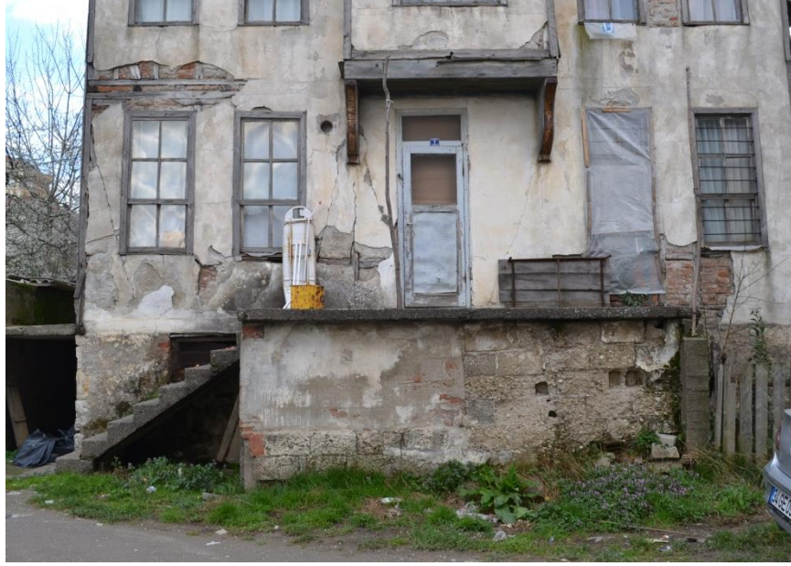
Şekil 4. 16 : Güney Cephedeki Kullanılmayan Giriş Kapısı, Beton Sahanlık ve Merdiven (Kara, 2013)
