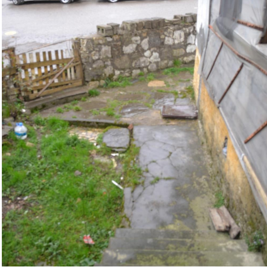
Şekil 4. 11 : Bahçe Ana Giriş Kapısı ve Kapı Önü Zemini (Kara, 2013)
