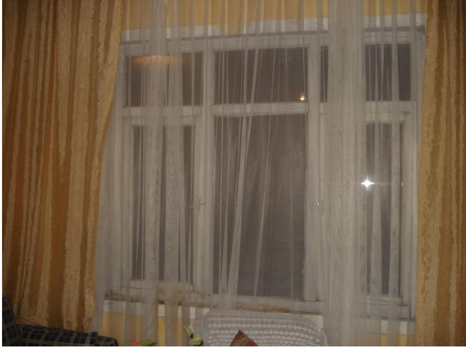
Şekil 4. 54 : Z/05 Mekanının Kuzey Duvarındaki Niteliksiz Pencere (Kara, 2013)
